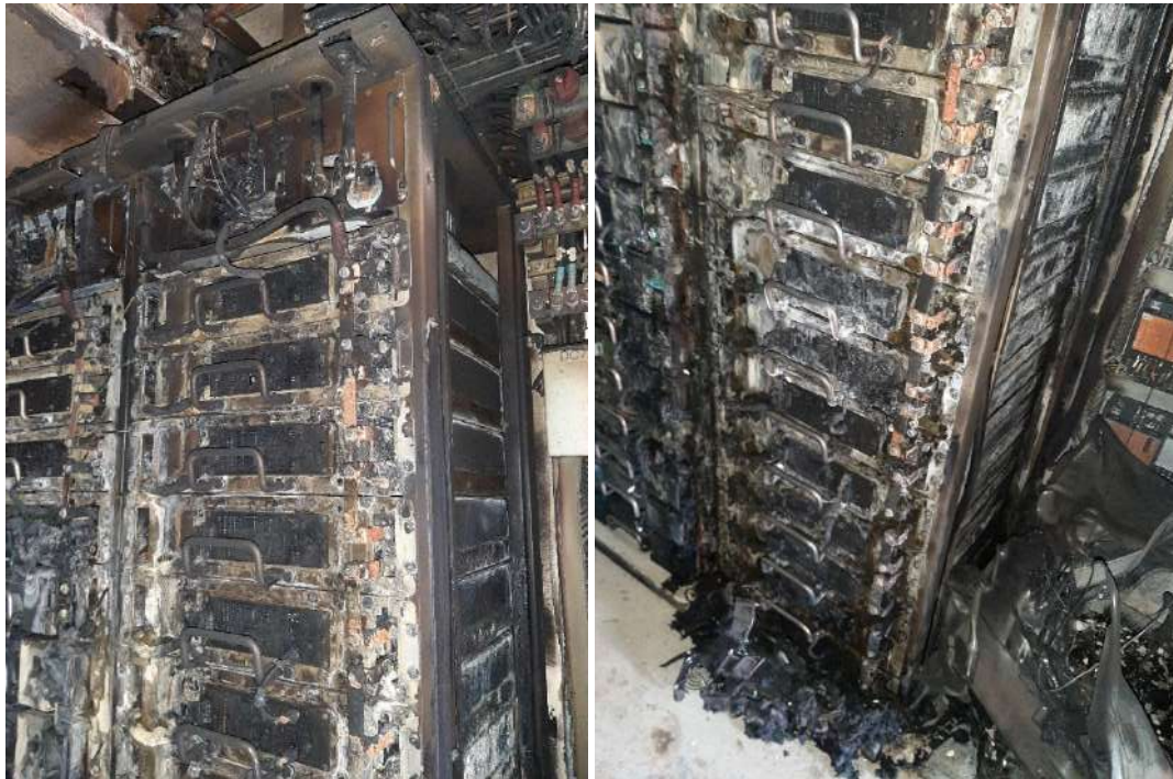
Figure 13 : Rack B3R1, le plus détérioré
