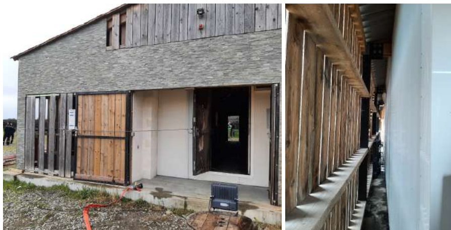
Figure 3 : Vue traversant du conteneur incendié (gauche) et espace entre conteneur et bardage bois côté ouest (droite)
