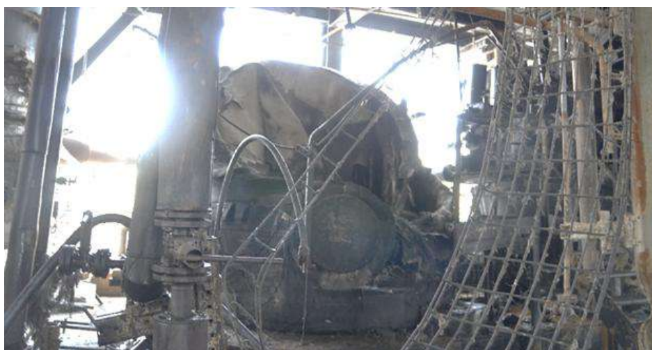
Photographie 2 : capacité éventrée, chemins de câbles affaissés
