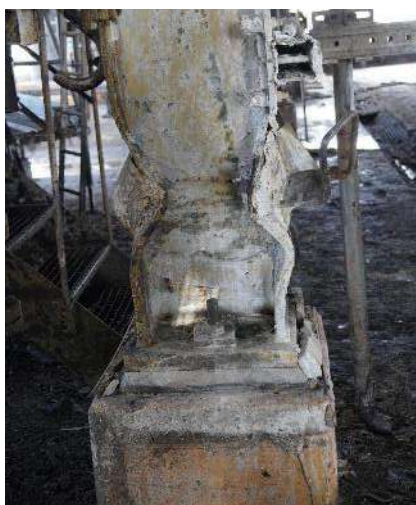
Photographie 1 : déformation structurelle d'un pilier de soutènement de l'atelier
