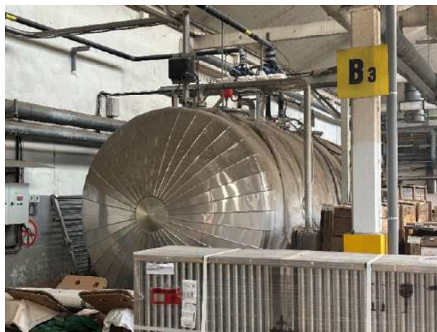
Figure n°4 : Cuve d'hydroxyde de sodium située à l'intérieur de l'usine qui devait recevoir la livraison (Crédit BEA-RI)
