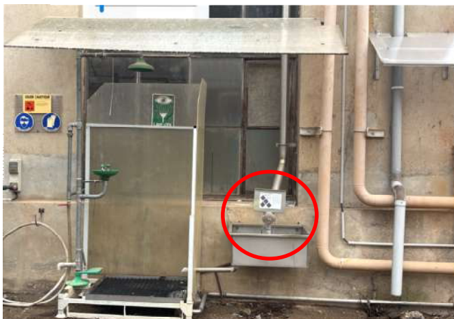
Figure n°3 : Raccord extérieur de remplissage de la cuve d'hydroxyde de sodium (Crédit BEA-RI)
