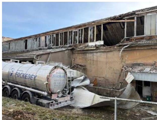
Figure n°2 : Vue du camion-citerne et des débris de la cuve d'eau oxygénée après l'explosion (crédit : SDIS 68)
