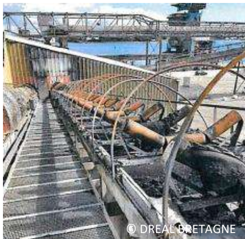
ARIA 57953 – Feu de bandes transporteuses d'un silo portuaire
