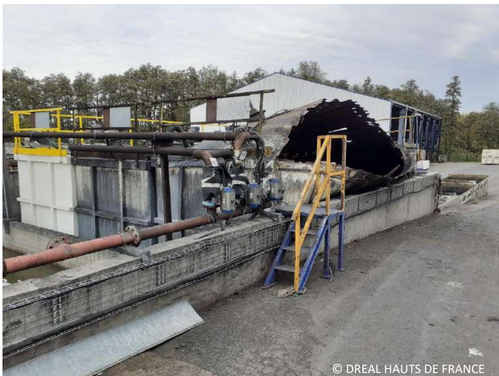
ARIA 59882 – Explosion d'une cuve ayant contenu des déchets de solvants
