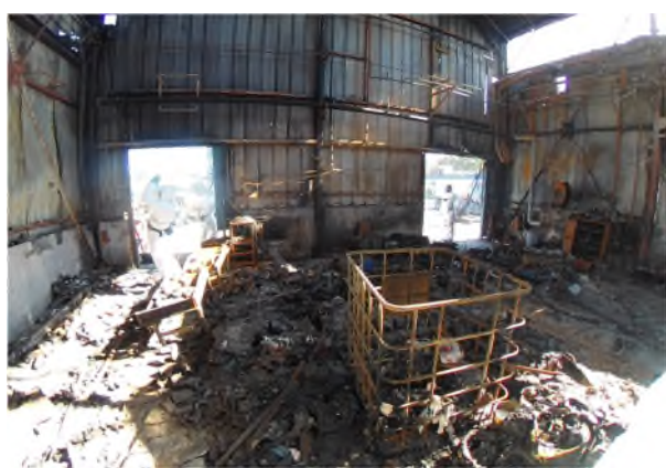
Photographie 14 : vue des deux entrées du local DDD. A gauche la zone du départ de l'incendie.
