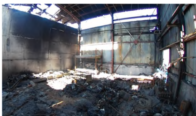
Photographie 12 : vue du local DDD après l'incendie
