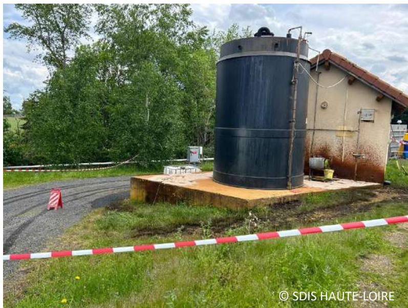
ARIA 62284 – Fuite de chlorure ferrique dans une fromagerie
