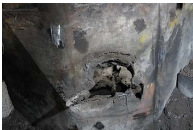
Photographie 8 : Trou provoqué par la fusion du four en partie basse de la paroi verticale de la cuve.
