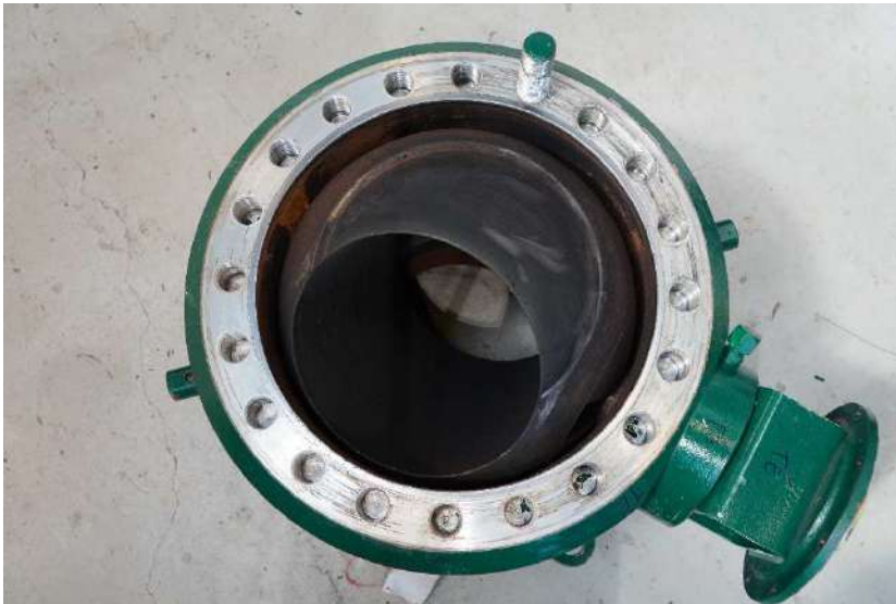
Photographie 7 : Positionnement de la vanne MV-171-1 au démontage
