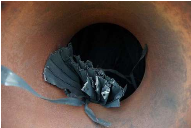
Photographie 3 : lamelles métalliques du filtre expulsées par le souffle de l'explosion par la conduite supérieure
