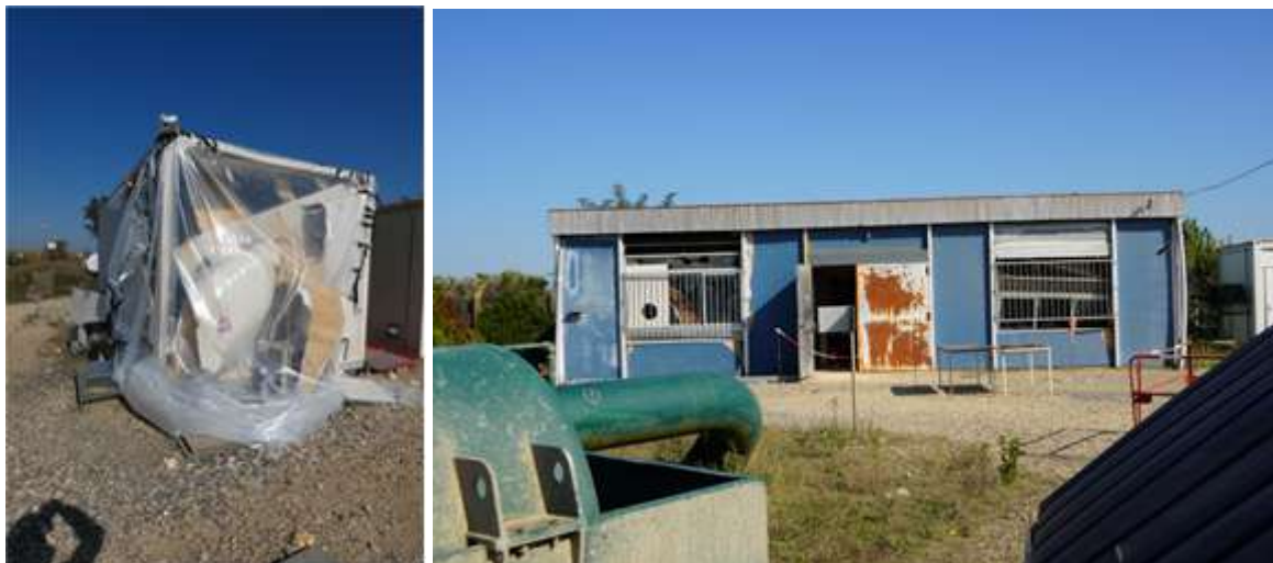
Figure 6 : dégâts sur les bâtiments – à gauche, le local technique à 25 m ; à droite, locaux préfabriqués à l'entrée du site, à 70 m.
