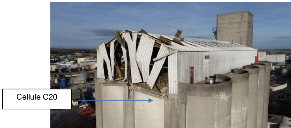
Figure 3 : Prise de vue du sommet du silo après l'accident du 6 janvier 2023 et avant le retrait des éléments de bardages de la galerie sur cellules [photo transmise par le BEA-RI]
