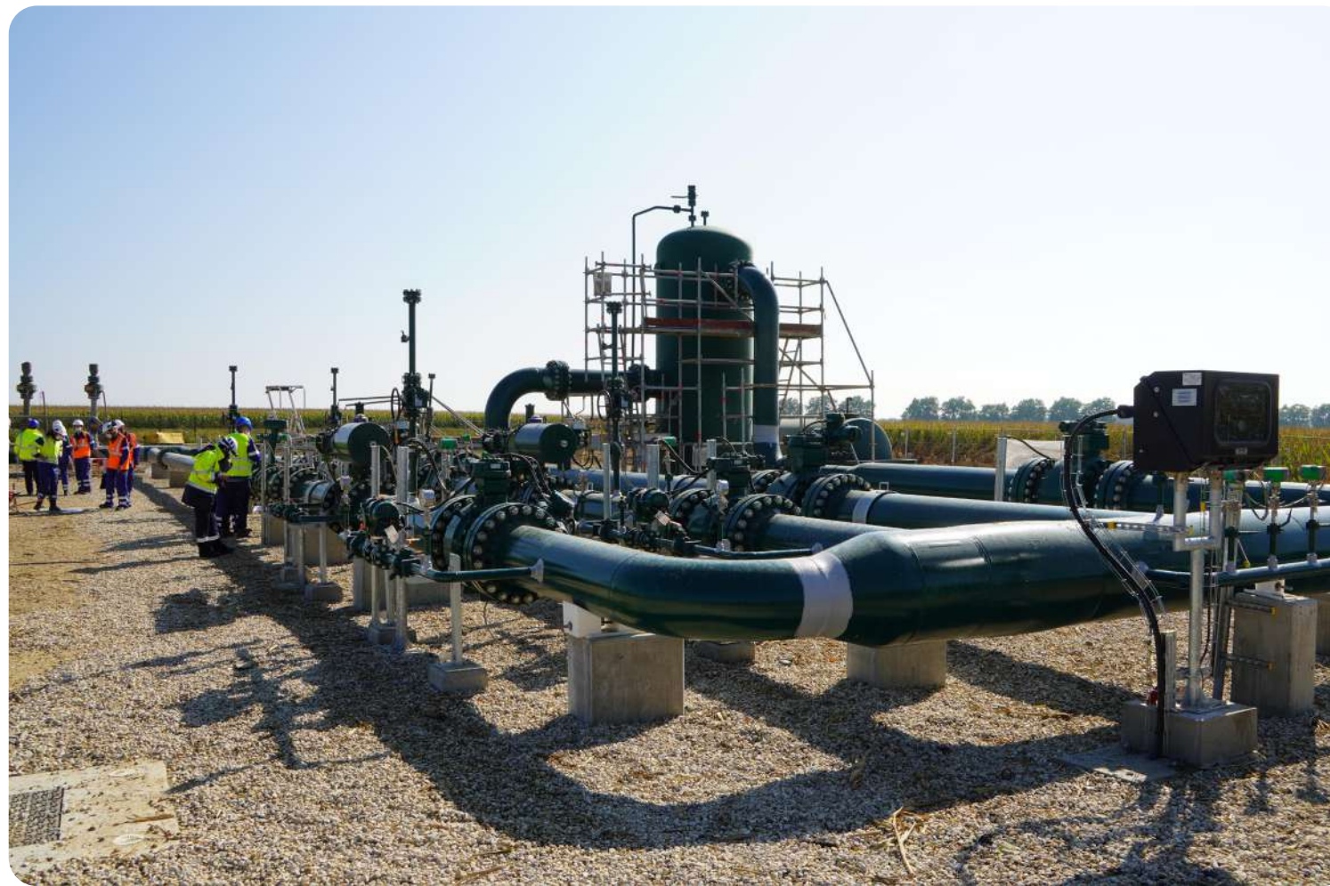
Station d'interconnexion GRTgaz - Ars-sur-Formans (01).
