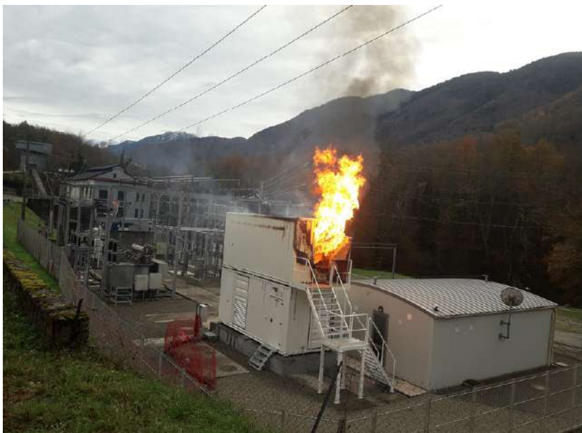
Incendie d'un conteneur à batteries (RTE - Perles-et-Castelet- 09).
