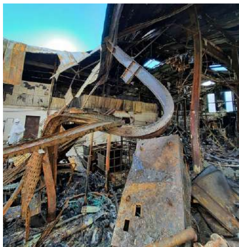
Poutrelle métallique déformée par la chaleur de l'incendie (STI France - Escout - 64).
