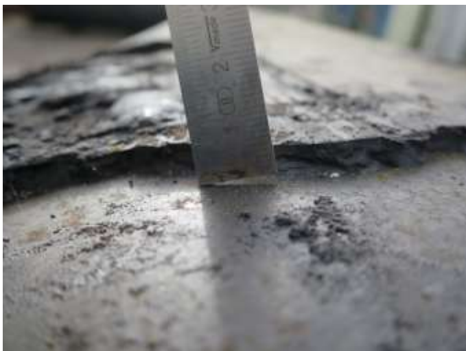
Figure 9 : Vue du brai à l'écart de zones souillées (T9)
