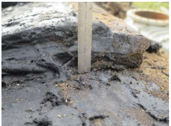
Figure 10 : Vue du brai dans une zone souillée (T9)
