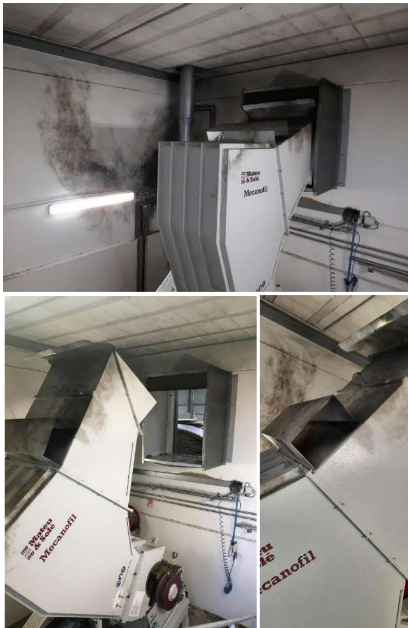
Figure 4 : Vue des traces de combustion dans le local broyeur
