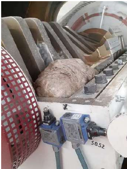
Figure 6 : déchets retrouvés dans le broyeur
