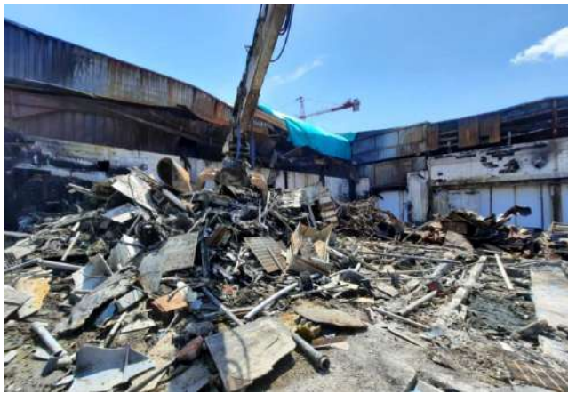
Photo 18 : Vue du local de galvanoplastie après sinistre
