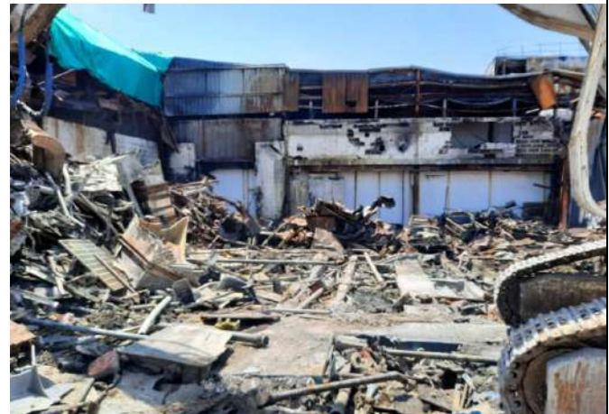
Photo 19 : Vue du local de galvanoplastie après sinistre
