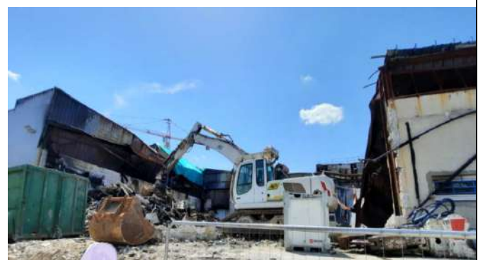
Photo 21 : Vue du local de galvanoplastie après sinistre
