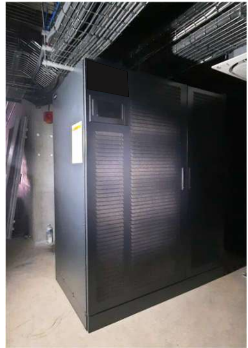
Photographie 12: système d'alimentation sans interruption (ASI) similaire à celui impliqué dans l'incendie
