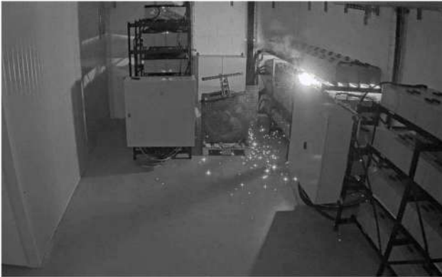
Photographie 6 : 0h35, départ de feu dans le local à batteries (source : image extraite de la vidéosurveillance OVH)
