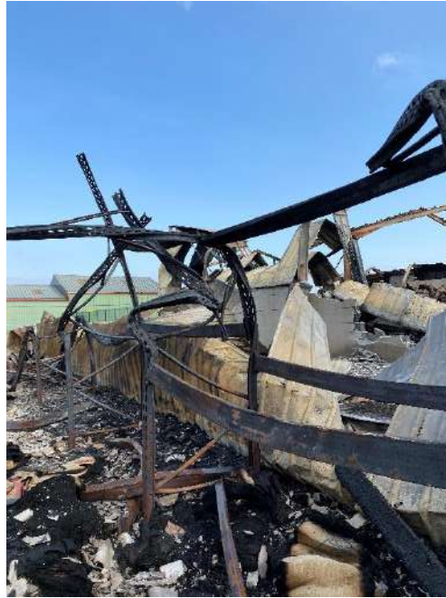
Photographie 3 : déformation des structures métalliques
