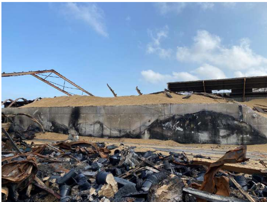
Photographie 1 : photo du site après l'incendie
