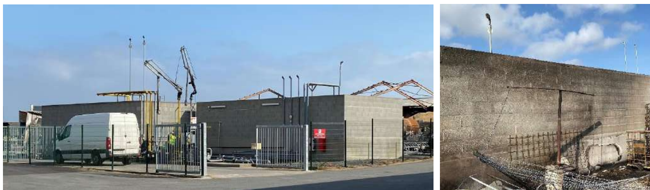
Photographie 6 : mur coupe-feu de l'installation de distribution de liquides inflammables
