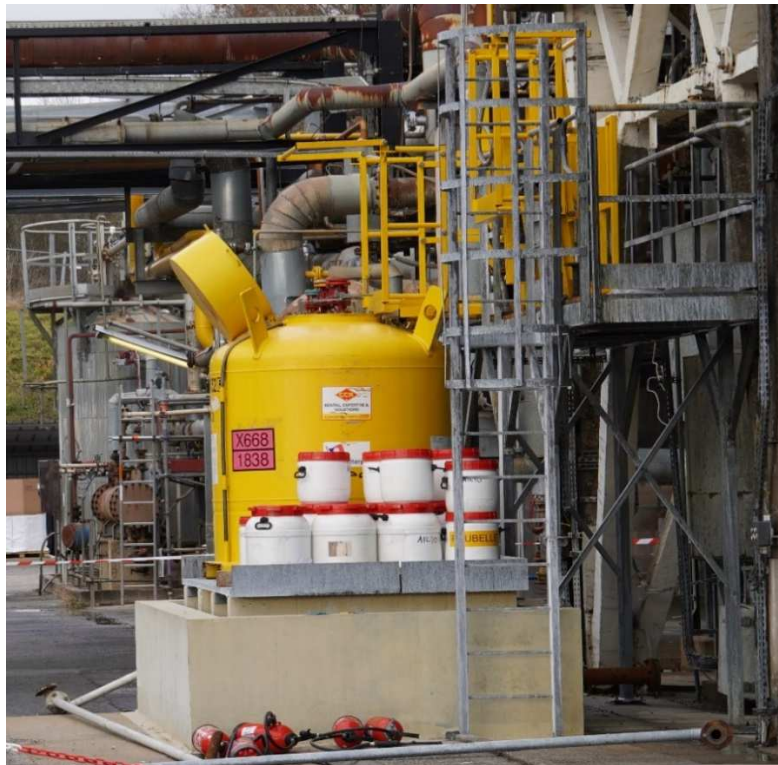
Photo 1 conteneur (en jaune) sur le poste de dépotage
