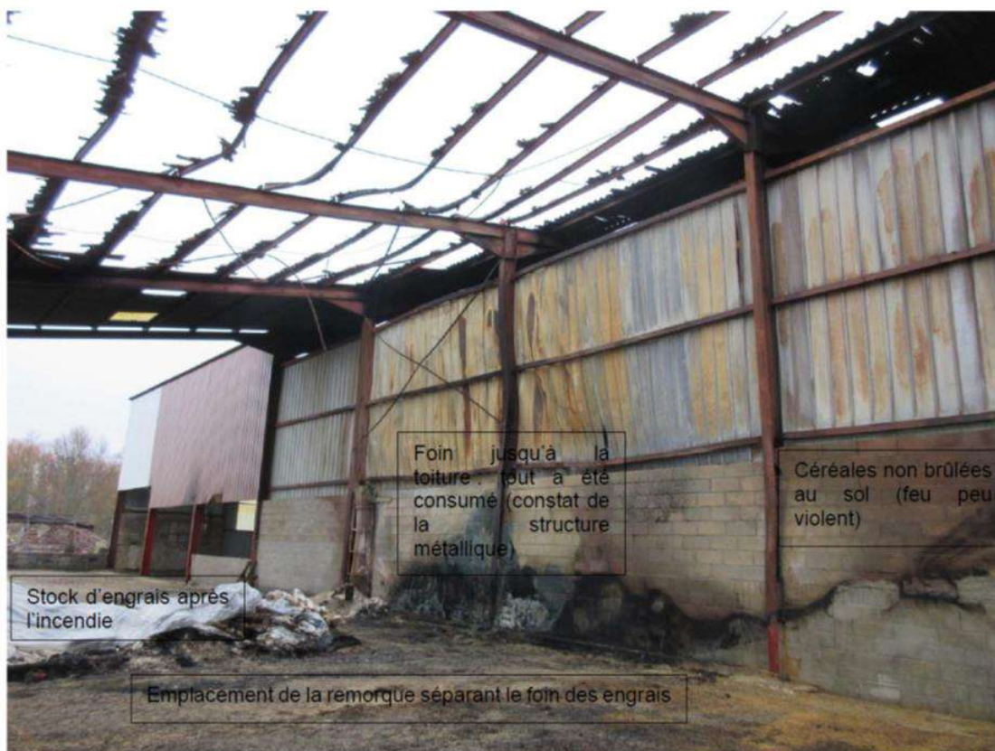
Figure 8 : Incendie à proximité du stockage des engrais
