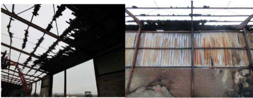
Figure 7 : Vue d'un poteau flué et d'un poteau intact (centre du hangar) ; poteaux intacts
