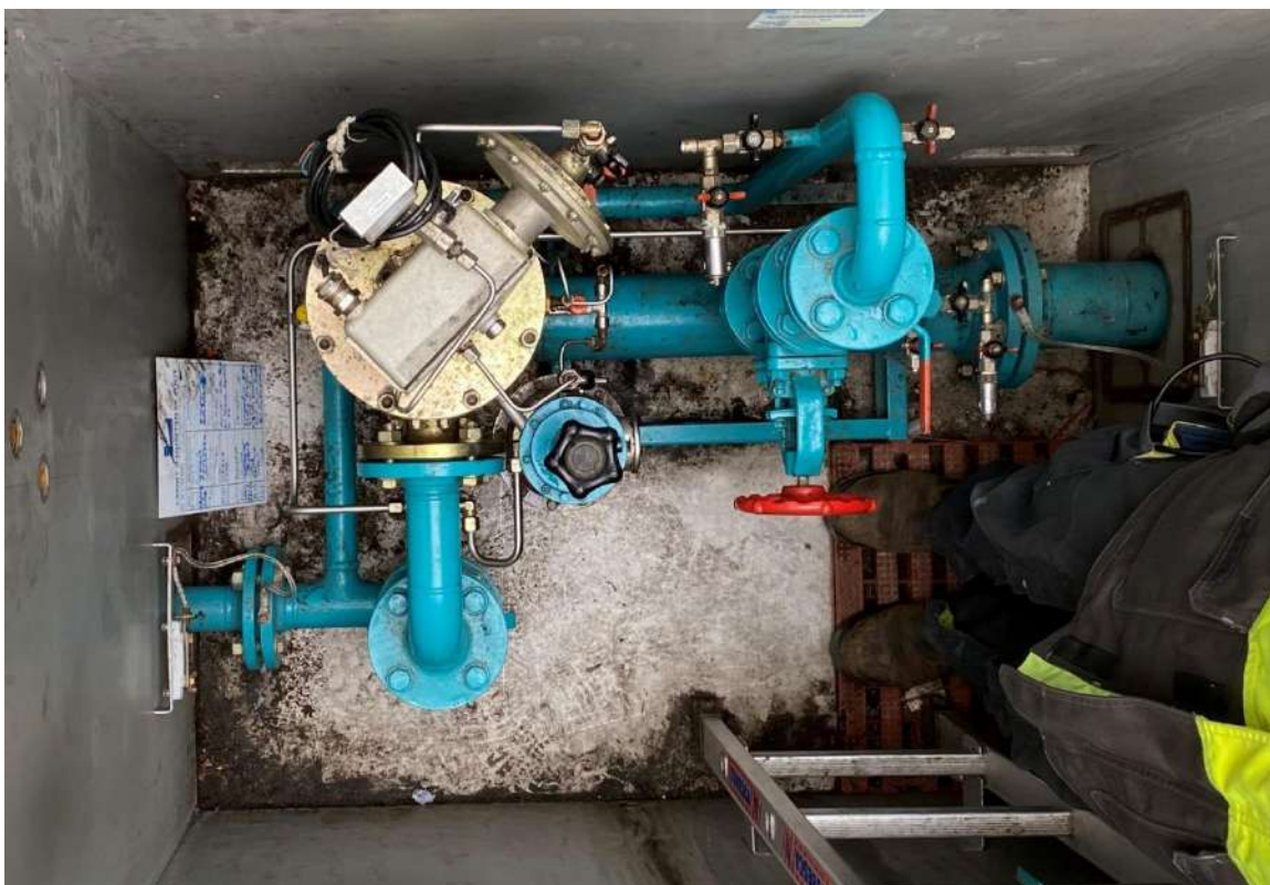
Figure n°5 : vue du dessus du poste de détente
