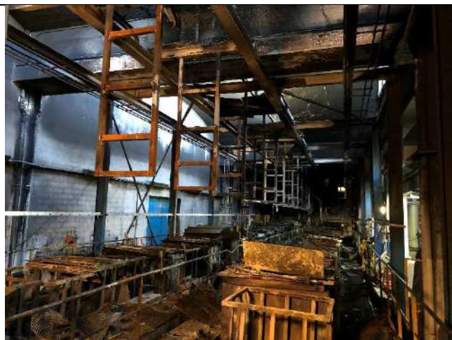
Photo 1 : Vue des chaines acier / alliages légers et du mur coupe-feu sur la gauche
