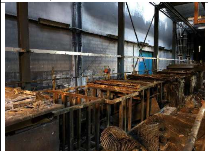
Photo 21 : Vue d'une partie de ligne totalement consumée
