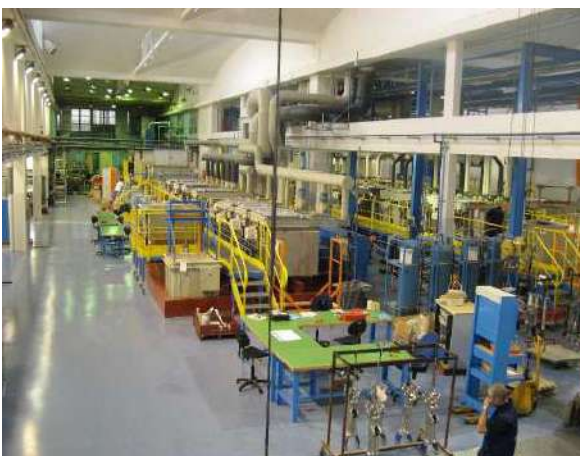
Figure 7 : Le local de traitement de surface aujourd'hui. Un mur coupe-feu 2h a été créé séparant le local de l'atelier mécanique. On peut apercevoir également l'unité d'aspiration des vapeurs d'acides.
