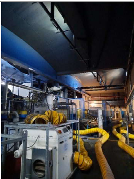
Photo 12 : Vue des alvéoles du plafond au-dessus des chaînes de traitement de surface
