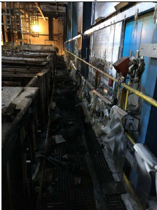
Photo 3 : Vue du caillebotis extérieur et des pare-éclaboussures
