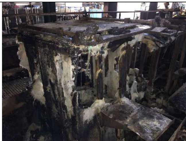
Photo 20 : Vue d'un baign d'acide ayant totalement fondu et ayant perdu sa solution
