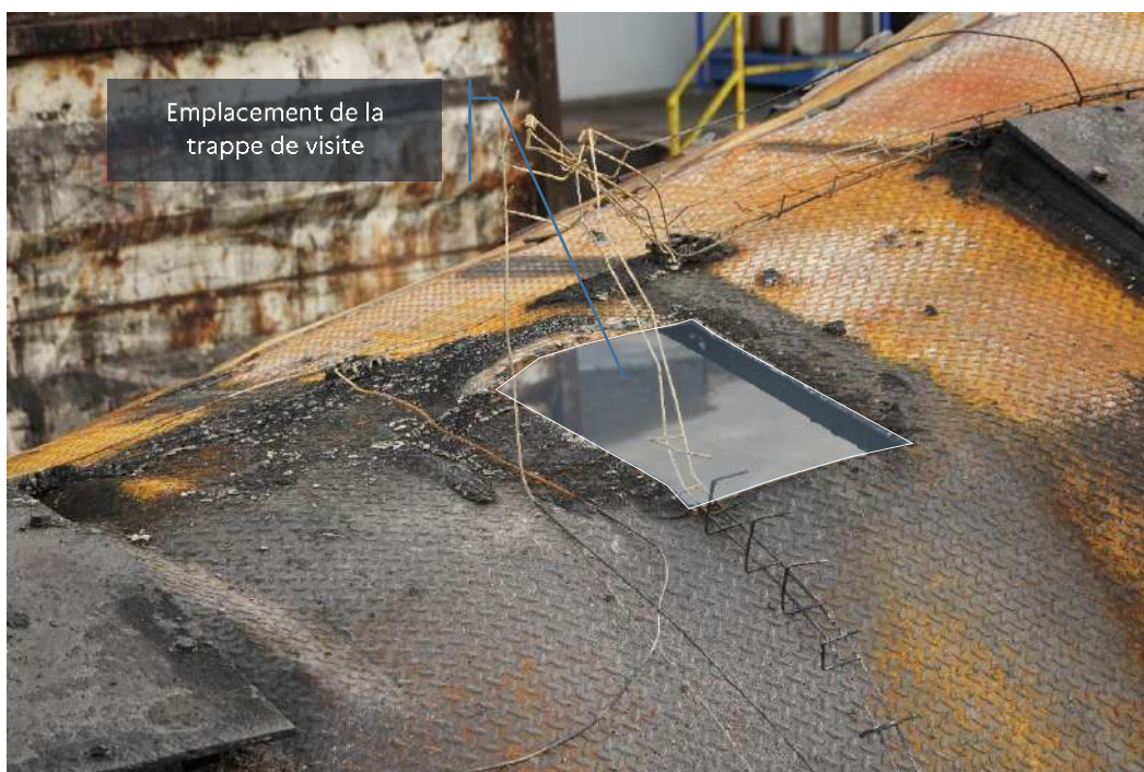
Photographies 1 et 2 : Photographies de la cuve quelques jours après l'explosion
