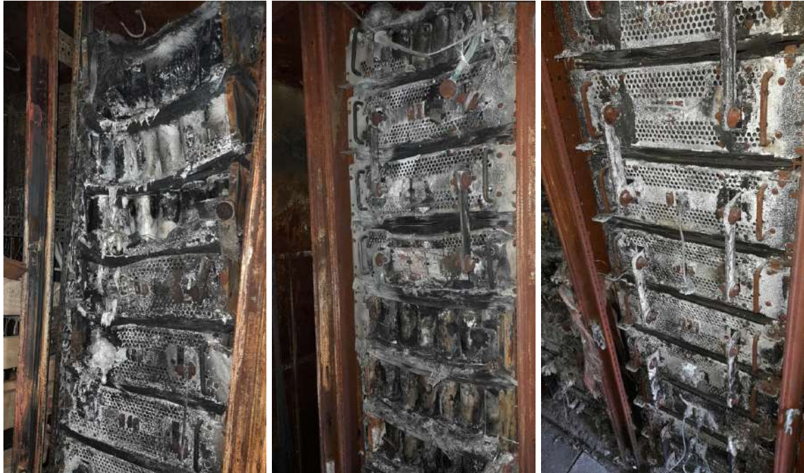
Figure 27: Racks supercondensateurs, du plus proche (gauche) au plus éloigné (droite) de la porte du container
