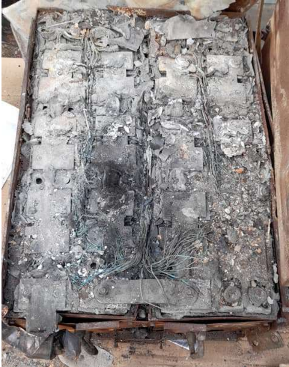
Figure 31: Prélèvement du module n°1 du rack batteries n°2 : vue de dessus
