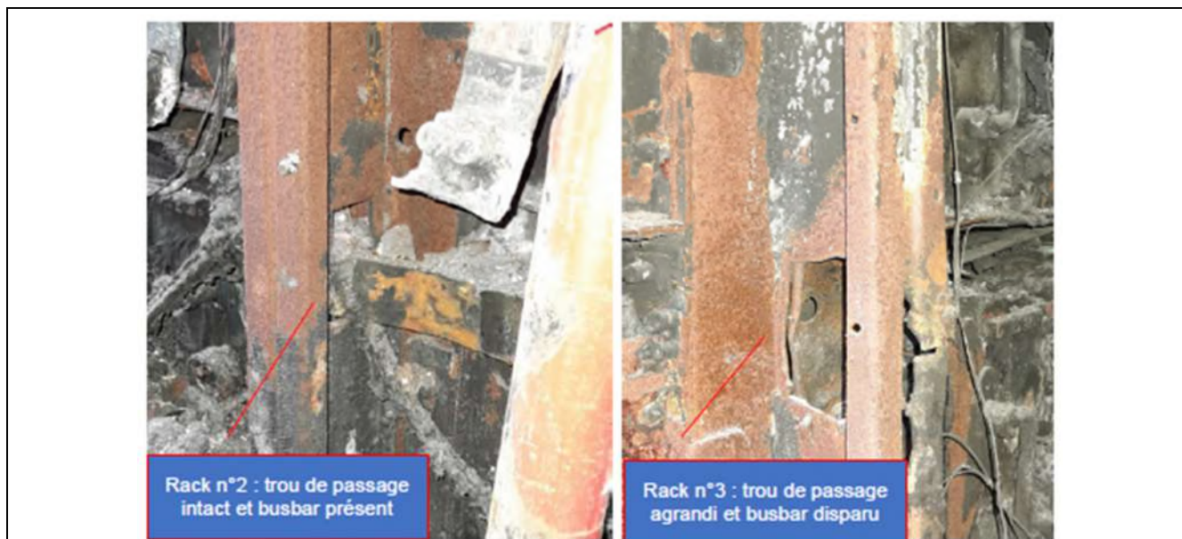
Passage du Busbar entre module 7 et 8 du rack 3. Comparaison avec passage de busbar d'un autre module (source rapport Ineris)
