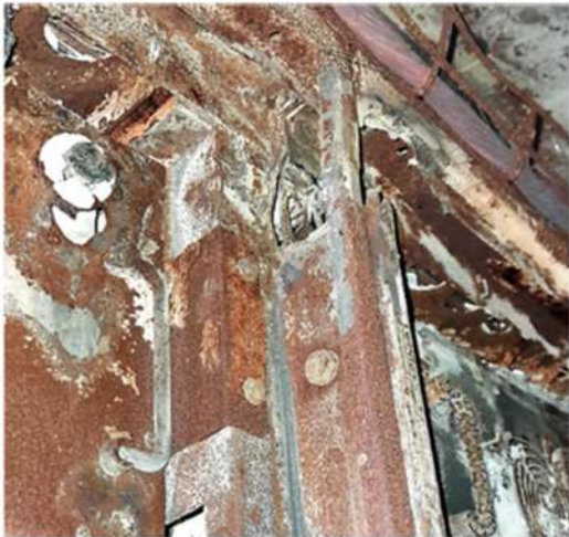
Photo 2 : passage du busbar en aval du module 15 (Source Rapport Ineris)
