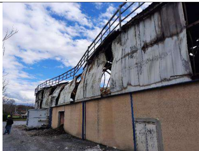
Photo 4 : Vue extérieure selon prise de vue n°4. Cette façade présente les désordres structurels les plus importants.
