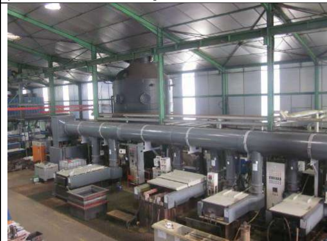
Photo 13: Vue de la zone de production (point de vue G) avant l'incendie. On y aperçoit le système d'aspiration des vapeurs constitués de tubes et au second plan l'imposante tour de lavage en PEHD.
