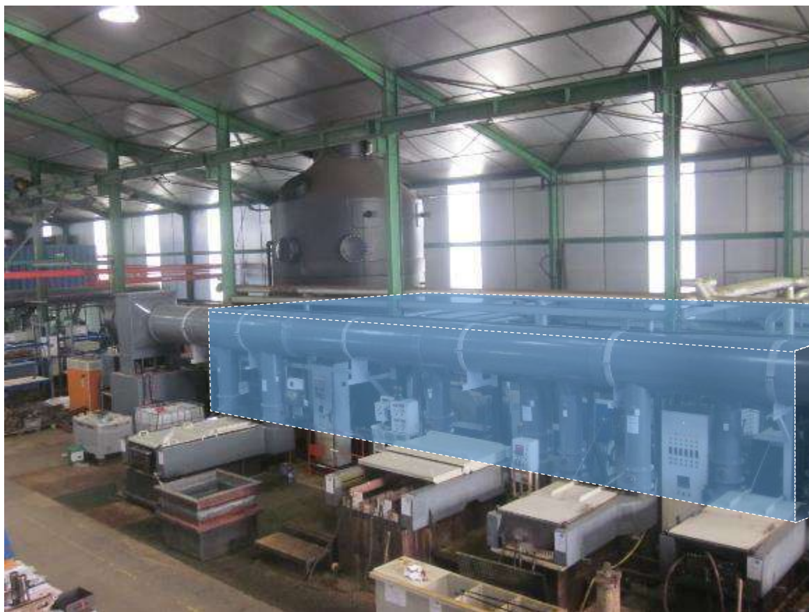
Photographie 5 : vue de la ligne de traitement de surfaces et de la zone où ont été constatés les défauts électriques.
