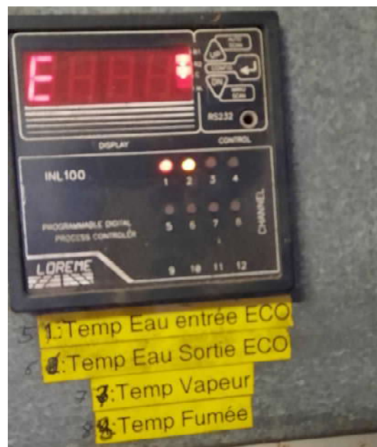
Figure 12 : capteur de température non fonctionnel
