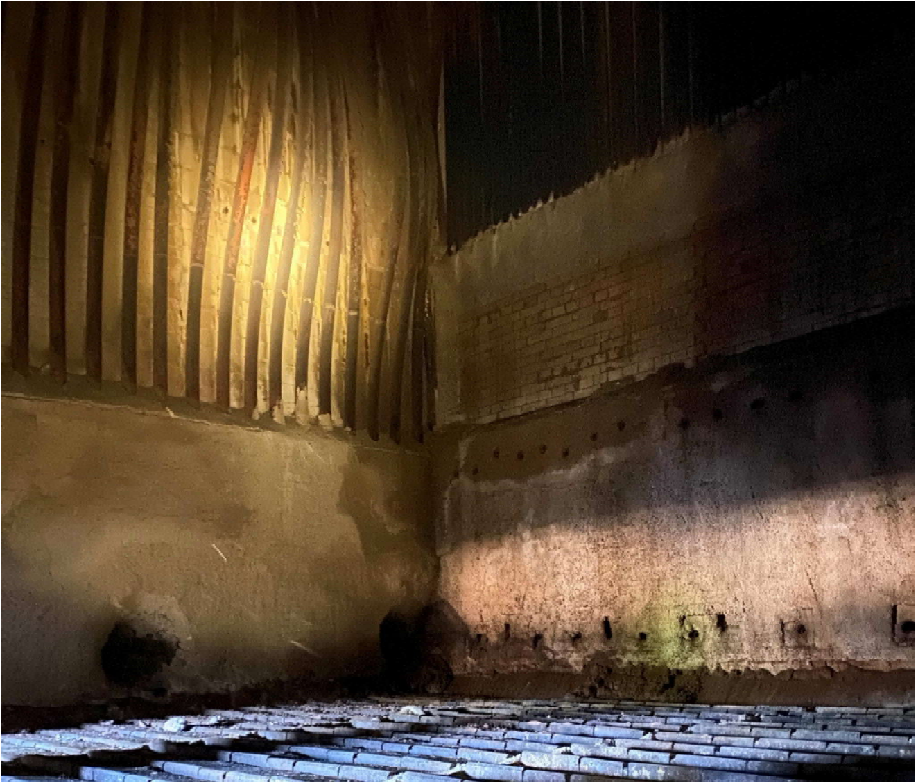
Figure 11 : constat de l'endommagement des tubes
