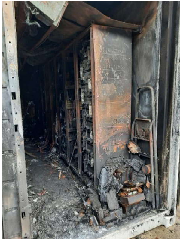
Photo 4 : Vue intérieure du container (côté supercondensateur)
