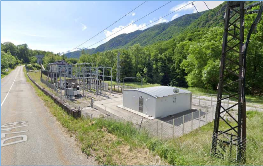
Figure 3 : Photo d'ensemble du poste de Perles et Castelet (source Google - Street View)
