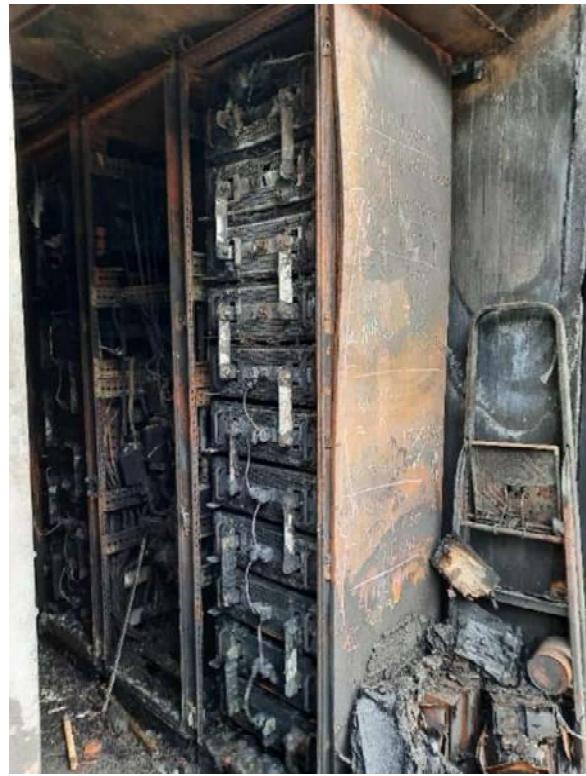
Photo 7 ter : vue d'un rack de modules de condensateurs souillés par la suie.
