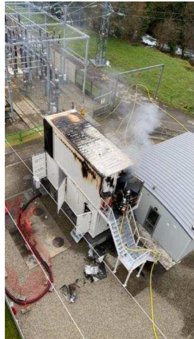
Photo 3 : Vue de l'installation (intervention des secours en cours)
