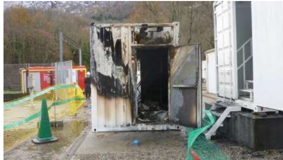
Figure 5 : Photo du conteneur de stockage d'énergie le lendemain de l'incendie
