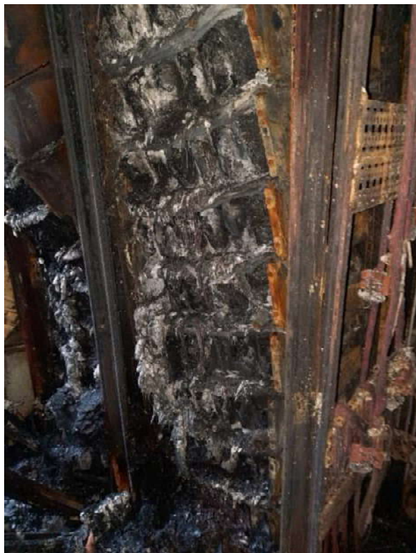
Photo 6 : Etat des condensateurs dans la zone 1. On constate une importante détérioration des composants électroniques.
