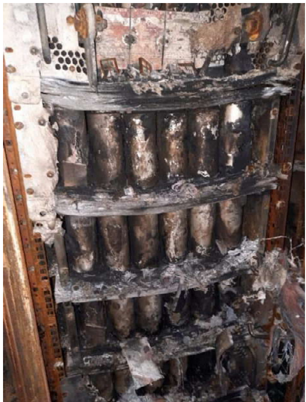
Photo 7 : Etat d'une armoire de condensateurs au milieu du container. Les condensateurs sont encore reconnaissables contrairement à la photo 6.
