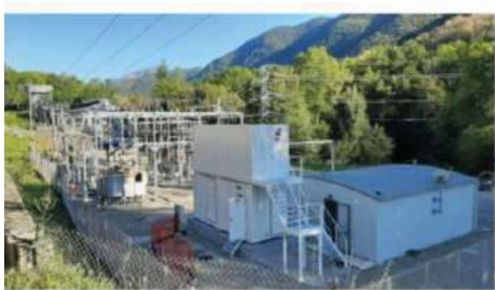
Figure 2 : Vue des deux containers
