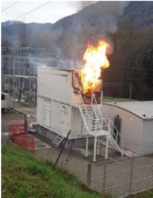
Photo 2 : Vue de l'installation durant l'incendie à l'arrivée des services d'incendie et de secours
