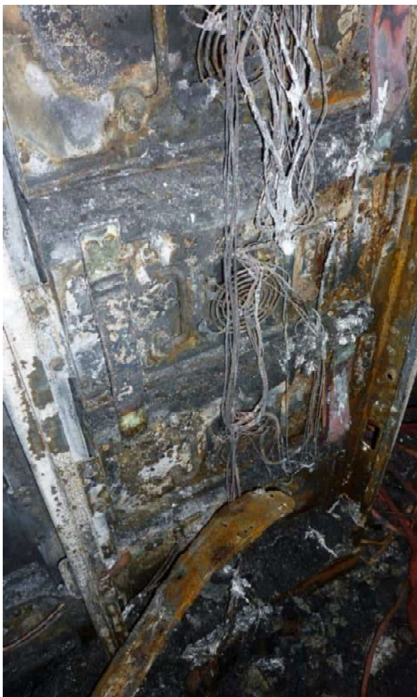
Photo 11 : photo du rack de batterie situé en face de la zone 1 identifiée comme étant la zone d'intensité maximale du foyer
