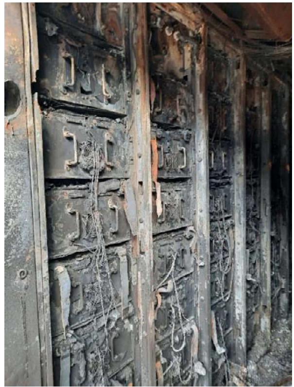
Photo 5 : Vue intérieure du container (côté batterie)
