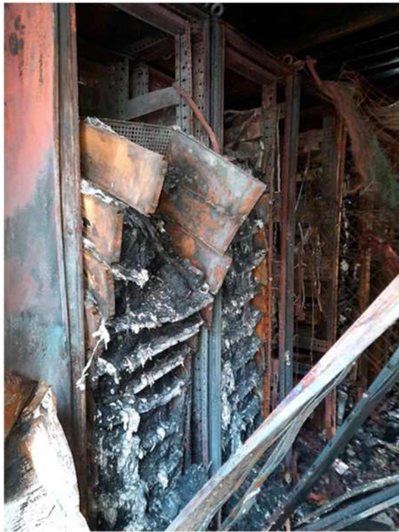
Photo 7 bis : rack de supercondensateurs détruits (Zone 1)
