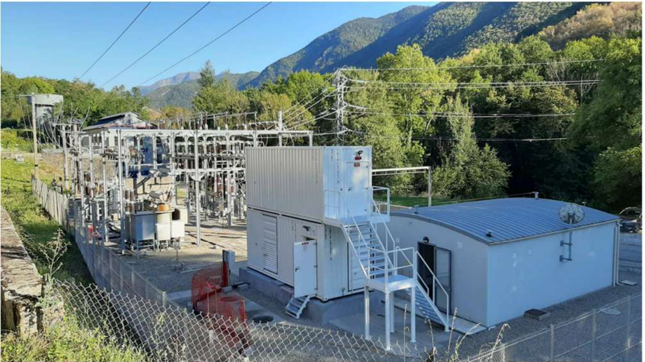
Photo 1 : Vue de l'installation Ingeteam au sein du poste RTE du Castelet
