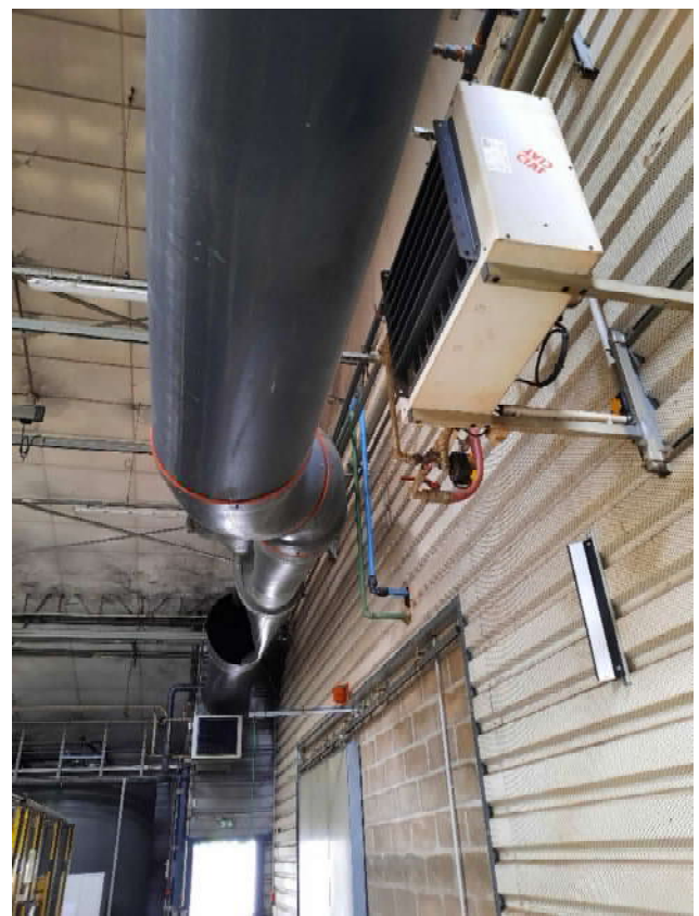
Photographie 5 : Photographie de l'émissaire déformé par la chaleur une vingtaine de mètres derrière le mur coupe-feu.
