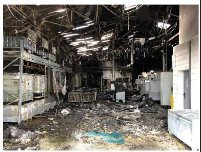
Photographie 3 : Partie du bâtiment qui n'était pas protégée par un mur coupe-feu (le feu s'est produit derrière le rayonnage où sont entreposés les GRV)
