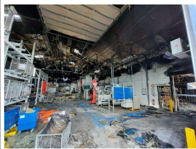
Photographie 2 : partie du bâtiment protégé par un mur coupe-feu partiel (le départ de feu a eu lieu derrière le mur en parpaings blancs). Toutefois, en l'absence de dépassement du mur en toiture ou d'étanchéité en sous-face, les fumées ont pu se propager.
