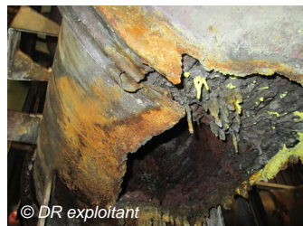
Rupture de l'échangeur de chaleur (vue de dessous)
