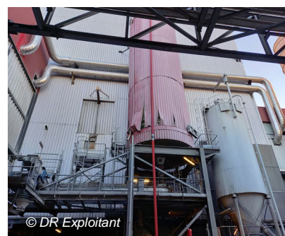
Silo de REFIO endommagé
