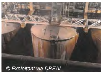
Image de la cuve suite à l'explosion
