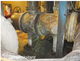
Echangeur de chaleur
