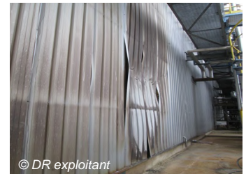
Dégât matériel visible à l'extérieur de l'atelier
