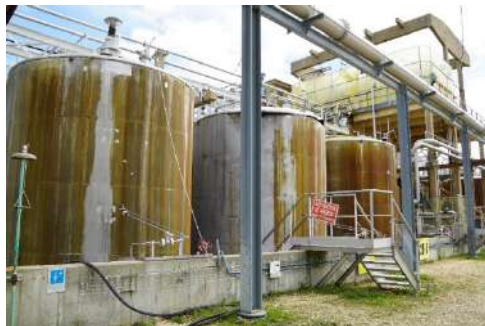
a. Cuve accidentée (au centre)
