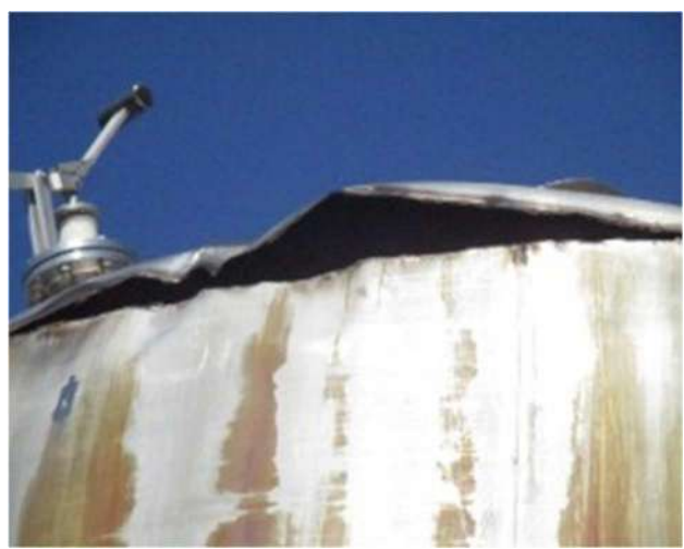
Photo 4 : Déchirure du dôme au niveau de la soudure
