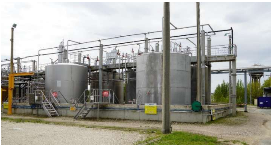
Figure 1. Photo du parc acides
