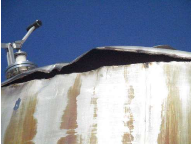
Figure 11 : Endommagement du dôme du réservoir (Source DREAL Nouvelle-Aquitaine)
