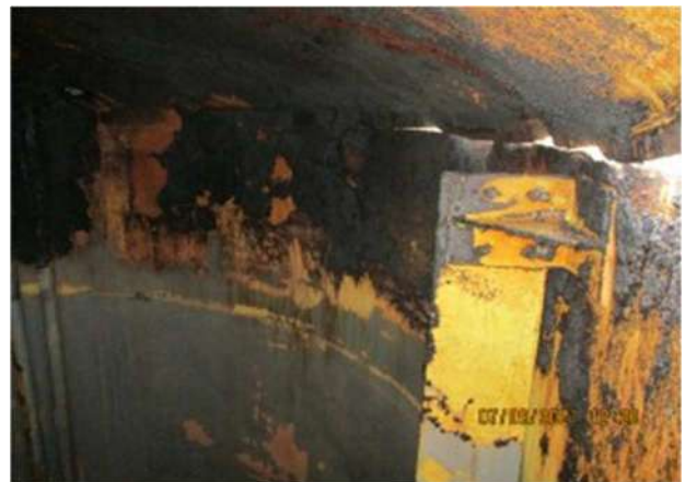
Photo 8 : Paroi intérieure du dôme dégradée
