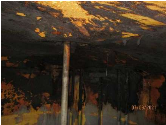
Figure 13 : Vue de l'intérieur du réservoir après l'explosion (Source DREAL Nouvelle-Aquitaine)
