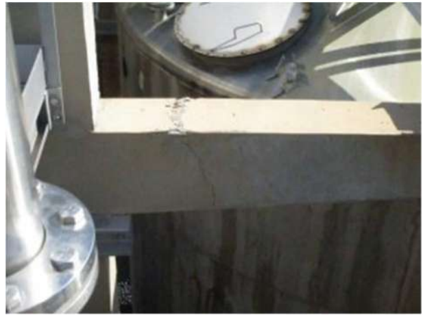
Photo 6 : Portique béton fissuré
