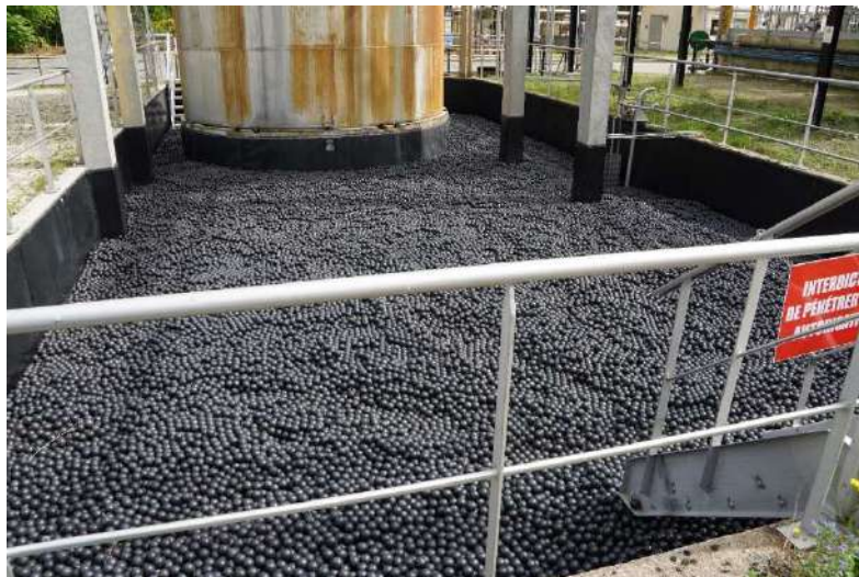
Photo 10 : Cuvette de rétention avec billes PEHD permettant de limiter l'évaporation des vapeurs acides
