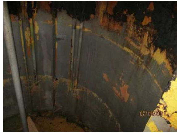
Figure 12 : Vue de l'intérieur du réservoir après l'explosion (Source DREAL Nouvelle-Aquitaine)
