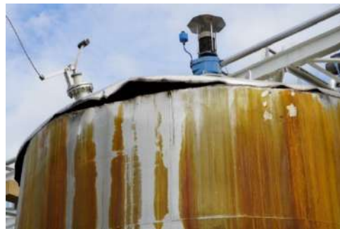
b. Déchirure de la soudure du dôme
