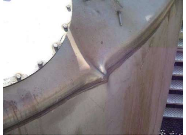
Figure 10 : Endommagement au niveau de la soudure de liaison entre la virole supérieure et le dôme du réservoir (Source DREAL Nouvelle-Aquitaine)
