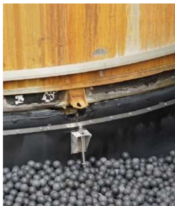
c. Rupture d'ancrages au sol
