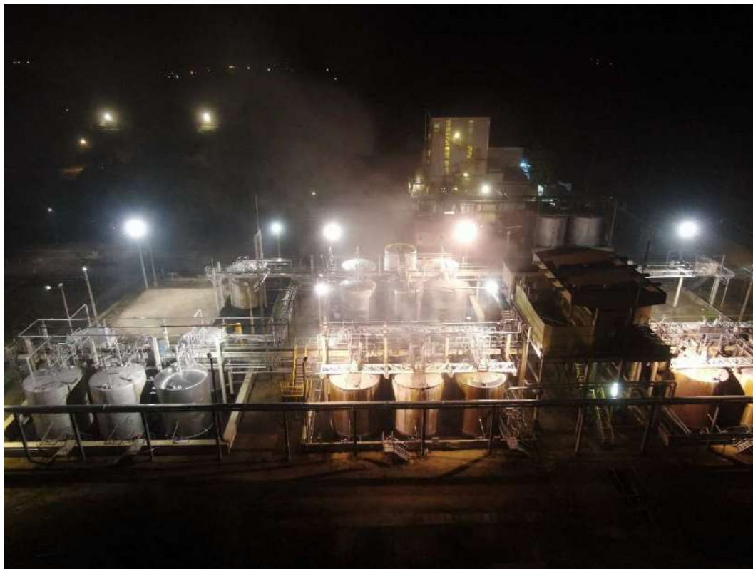
Photo 1 : Vue d'ensemble du parc acides le soir de l'accident (Source : SDIS 24)
