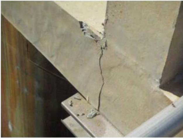
Photo 5 : Portique béton fissuré
