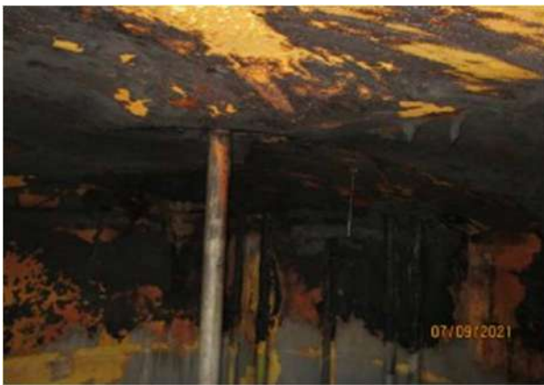
Photo 7 : Paroi intérieure du dôme dégradée
