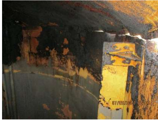
e. Etat de l'intérieur de la cuve après accident
