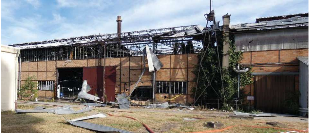
Figure 5 : Dégâts en façade Sud du bâtiment
