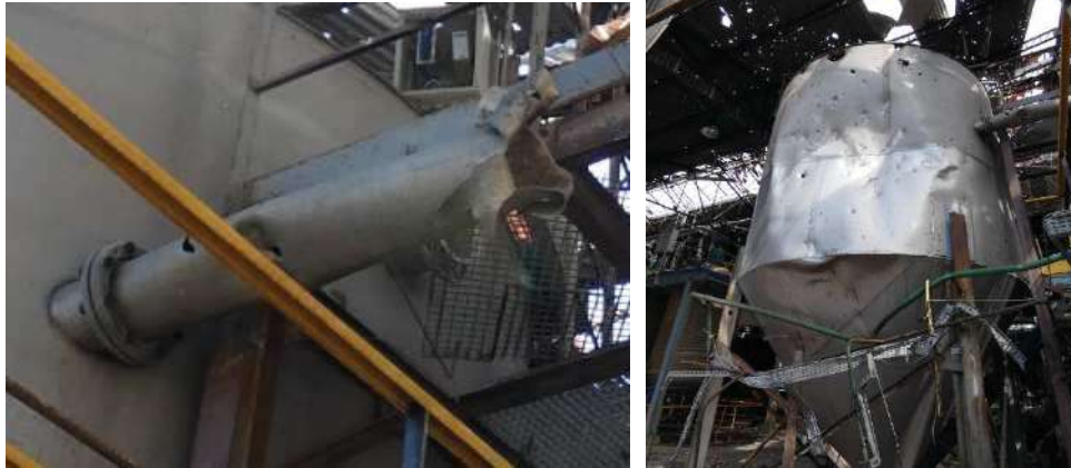
Figure 17 : Rupture de la tuyauterie entre la cuve « eaux blanches » n°2 et le décanteur et perforation de celle-ci (à gauche) et déformation et nombreuses perforations du décanteur (à droite)
