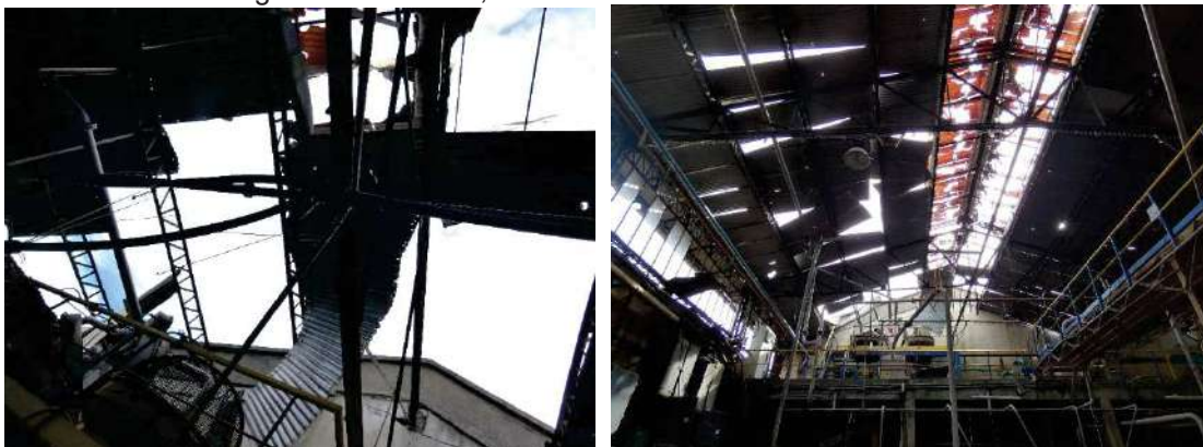
Figure 9 : Dégâts subis par la couverture de toiture – partie Nord
