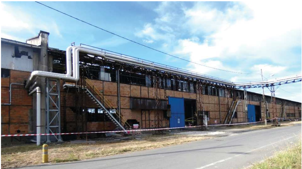
Figure 4 : Dégâts en façade Nord du bâtiment
