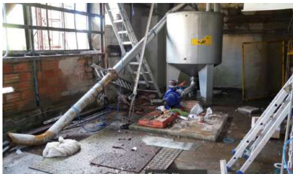
Photo 1 : Zone d'échauffement à l'origine de l'explosion initiale, avec vue de la nouvelle cuve eaux blanches qui était en cours de raccordement
