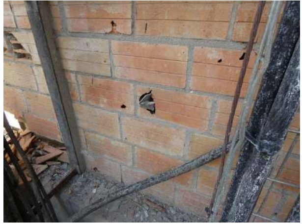
Photo 16 : Impacts d'éclats métalliques dans un des murs du bâtiment
