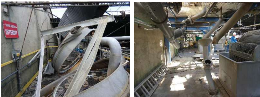
Figure 15 : Endommagement des tamiseurs et des canalisations acier, PVC associées
