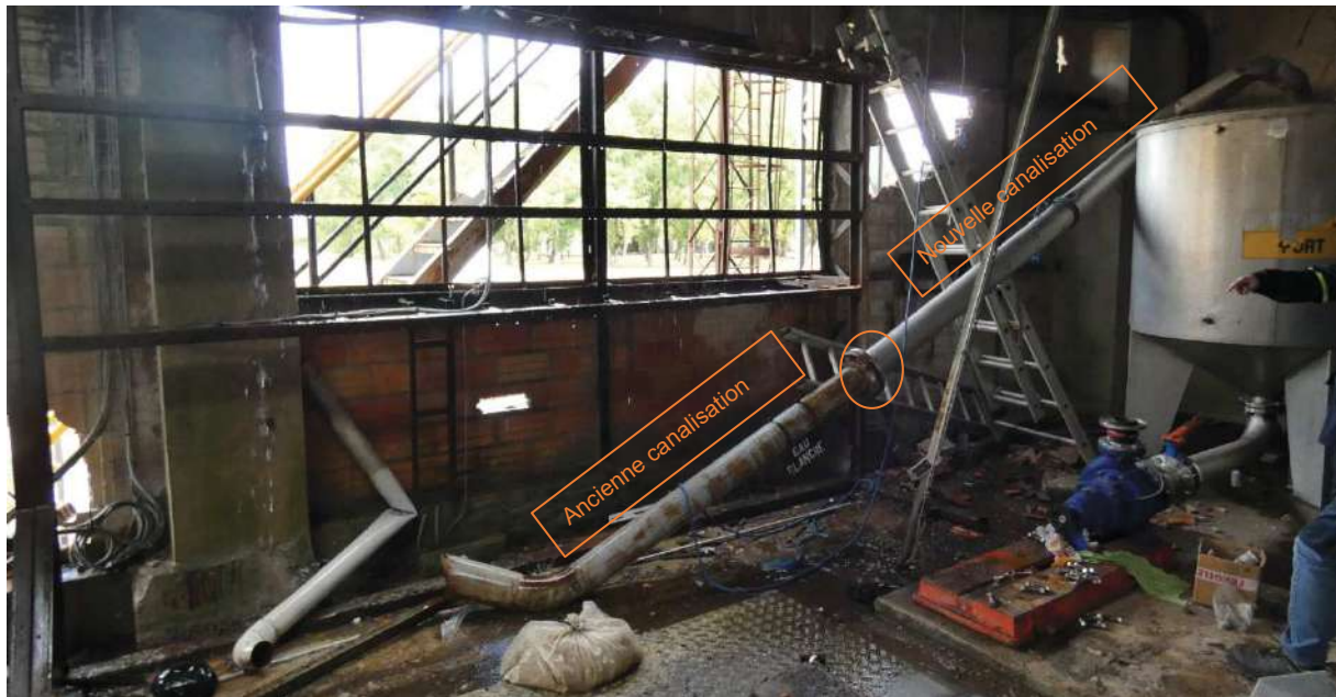
Figure 3 : Photo post accident de la canalisation en cours de raccordement
