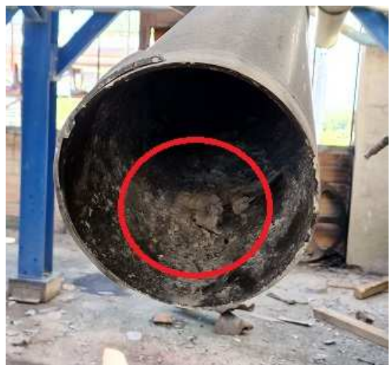
Photo 18 : État intérieur d'une canalisation PVC transportant des eaux blanches
