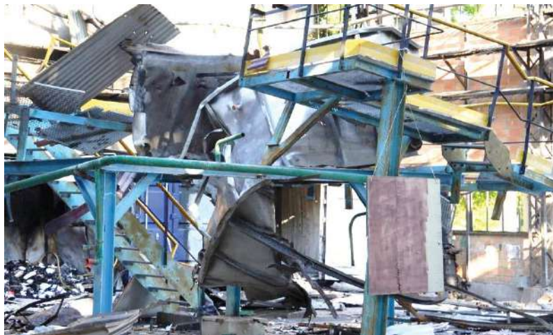
Figure 18 : Dommages subis par la cuve non raccordée
