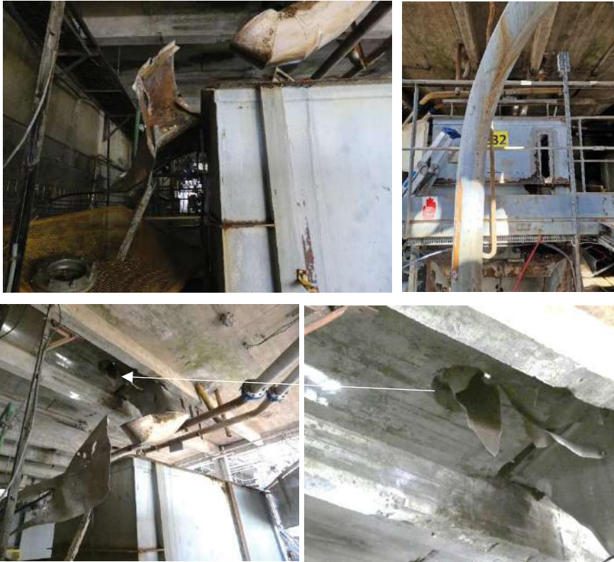
Figure 14 : Endommagement des battants et rupture de la vitre du bac de récupération 2 et rupture de la canalisation reliant ce bac aux tamiseurs
