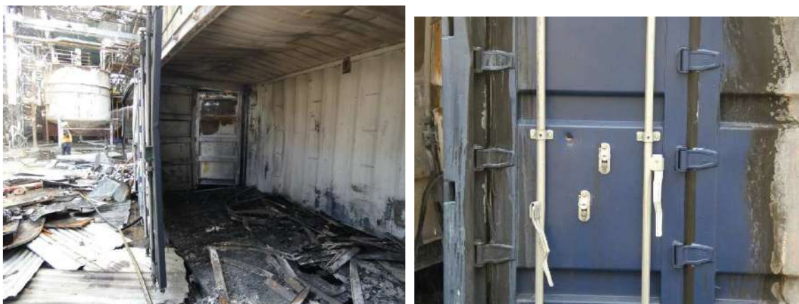
Figure 19 : Dommages subis par le container
