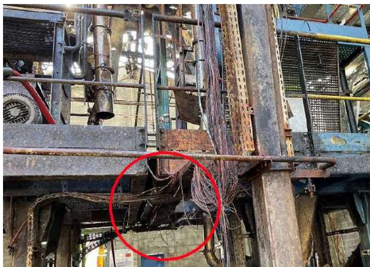
Photo 10 : Vue de la goulotte située entre les deux lignes de conditionnement (Source ARKEMA)
