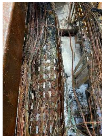
Photo 11 : Vue du chemin de câbles après l'incendie (Source ARKEMA)
