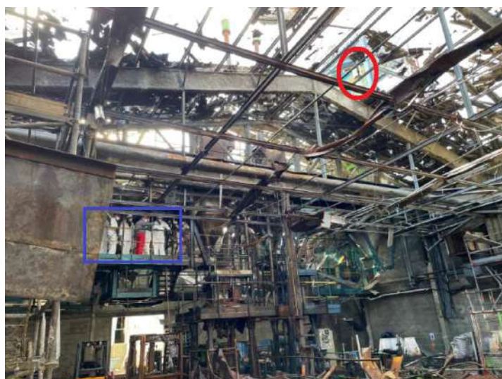
Figure 9 : Position d'une tête de l'installation d'extinction automatique à eau dans l'atelier (entourée en rouge) et taille humaine (rectangle bleu)
