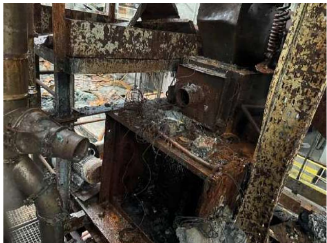
Photo 13 : Vue du même équipement après l'incendie. La gaine d'aspiration a brûlé lors de l'incendie (Source ARKEMA)
