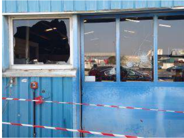
Figure 6 : Entrée AEB coté banc de test
