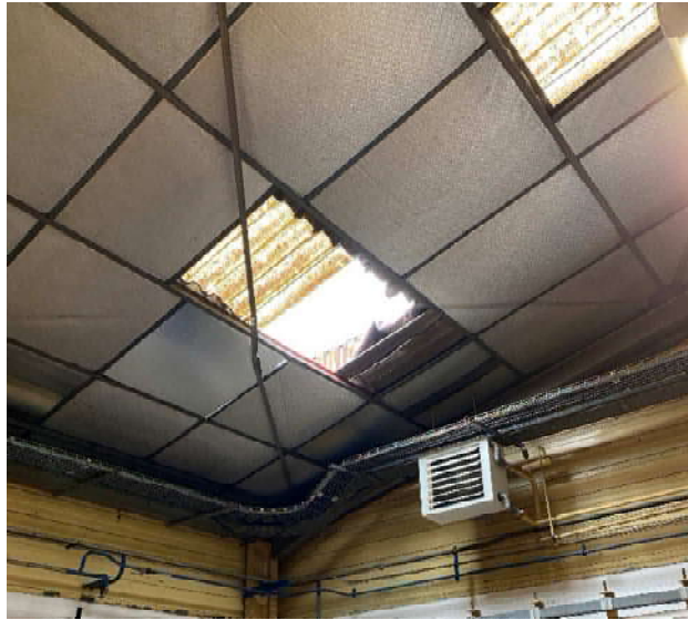
Figures 1, 1 et 3 : dégâts observés au sein de l'atelier AEB (atelier entretien bouteilles)
