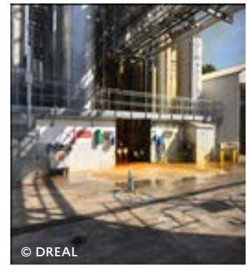
Fuite d'acide nitrique par incompatibilité d'un joint sur une cuve
