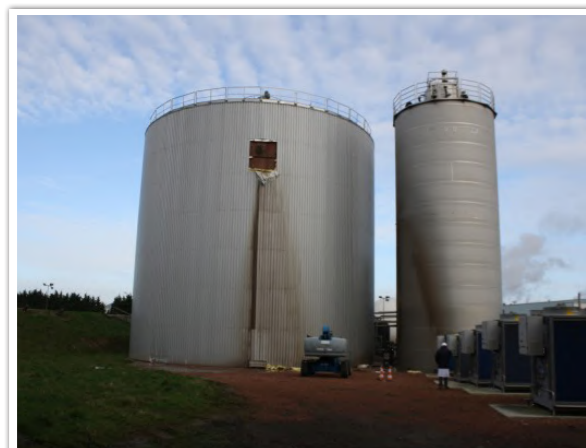
Fuite sur un digesteur © DREAL Hauts-de-France
